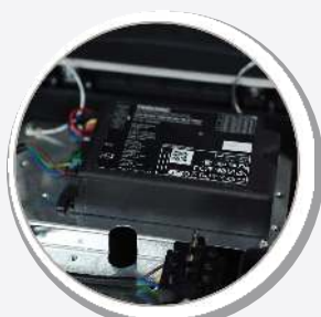
Compartimento del driver — placa de cableado extraíble
